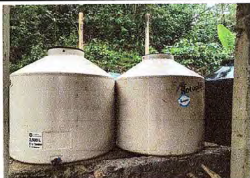
Foto1: Dos depósitos de agua nuevos e instalados para abastecer a la escuela.
